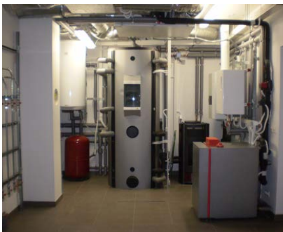
Obr. 5: Hydraulická stěna – 1.NP
