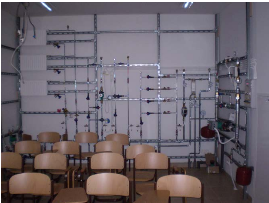
Obr. 5: Hydraulická stěna – 1.NP
